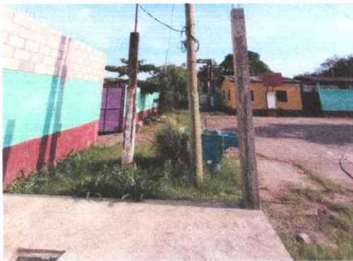
Foto 9: Vista interior del establecimiento, con intervención de remozamiento muro de block en la parte superior del muro perimetral lado derecho del portón de ingreso.
