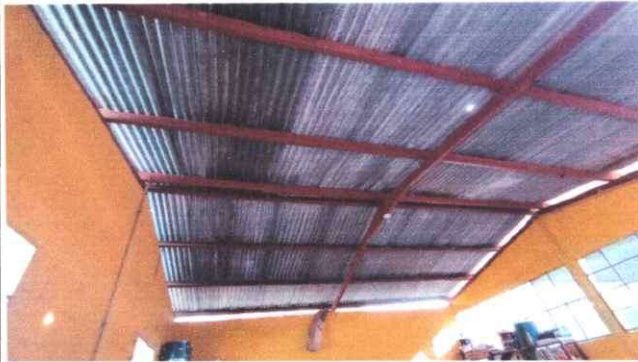
Foto1: Vista interior de módulo 3 de aulas, con intervención de remozamiento con mantenimiento a estructura y cambio de lámina.
