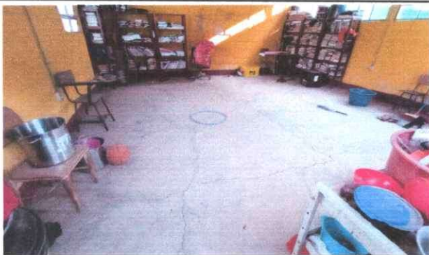
Foto 3: Vista interior de módulo 3 de aulas, con intervención de remozamiento con suministro e instalación de piso cerámico antideslizante
