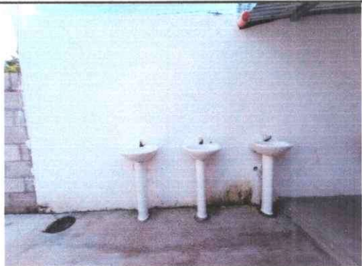
Foto 10: Vista exterior en servicios sanitarios, con intervención de remozamiento con suministro de techo en lavamanos.
